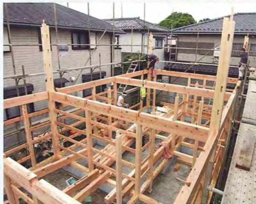
上左/土台と足固めはベタ基礎にアンカーボルトで緊結している。フリーにすることも可能。上右/柱が小屋梁を受け、その上に軒桁が載る折置き組（おりおきぐみ）。下/門型フレームによる建て方。
